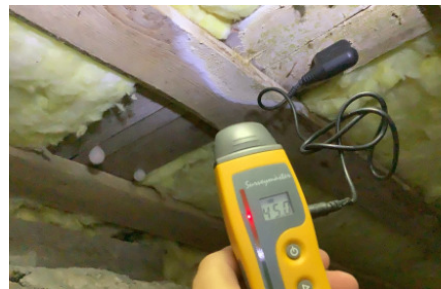
Fuktmåling fra krypkjeller viser forhøyede verdier i gulvbjelker
