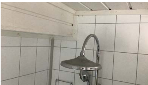
Lav takhøyde over dusj.
