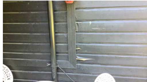
Kledningen er værslitt og har bobler i malingen. Dekkbord utvendig på kledning tyder på tidligere vindu eller lignende åpning.
