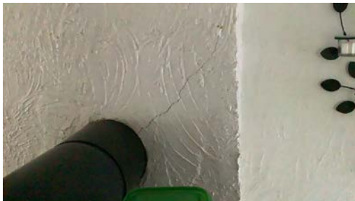
Det er rissprekk i pipe.
