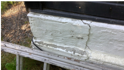
Det er registrert sprekker i muren utvendig.
