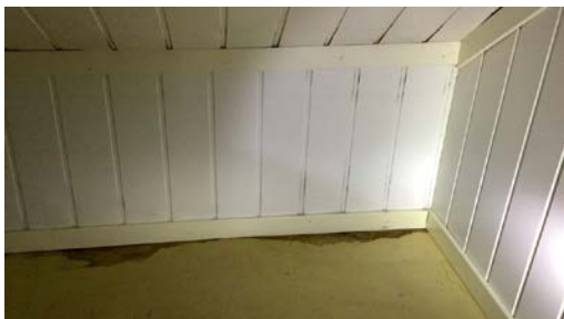
Skråtak går helt ned til yttervegg. Bildet viser tidligere kondensskade innerst i klesskap. Anbefaler videre undersøkelser.
