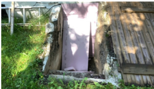
Utvendig trapp i betong og tredør. Vanger, trapp og tredør til kjeller må byttes.
