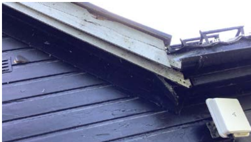
Vindskier bærer preg av røte og har løsnet enkelte steder.
