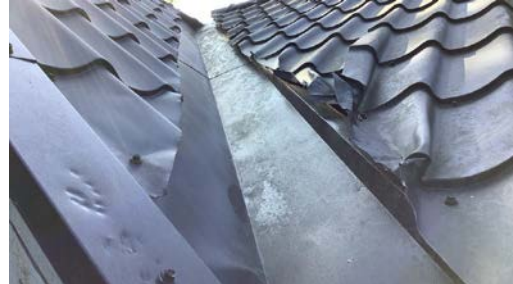
Beslag og takplater er deformert i gradrenne.
