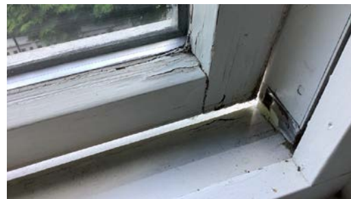
Enkelte vinduer har kondensmerker.
