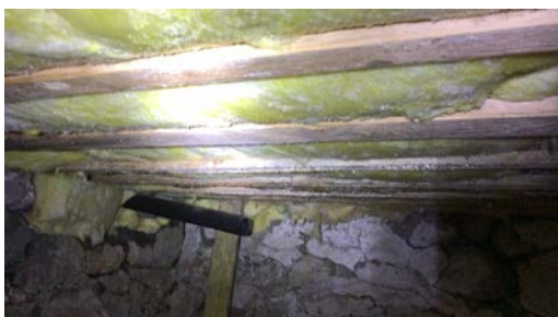
Isolasjon er lagt utildekket og er tydelig fuktig.
