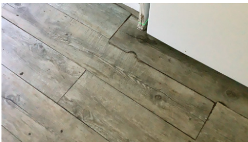
Laminat på kjøkken er ødelagt.
