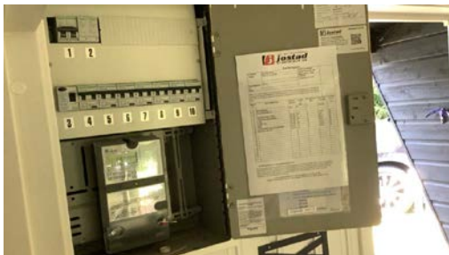
Bilde av sikringsskap.
