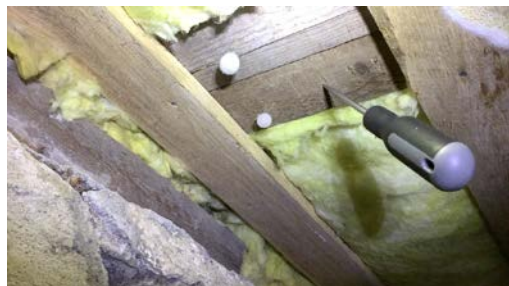
Typiske kjelleredderkopper. Tyder på fuktig klima
