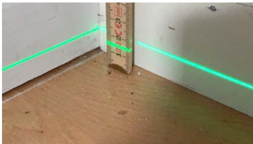
Det er målt 25 mm høydeforskjell i stue.
