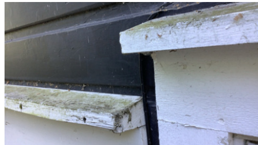
Manglende beslag inn i kledning over vindu/dør.
