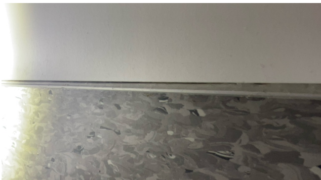
Litt krymp/oppsprekk i fuge mot endeveden på veggplater.
