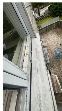
Glippe mellom vannbrett og vinduskarm
