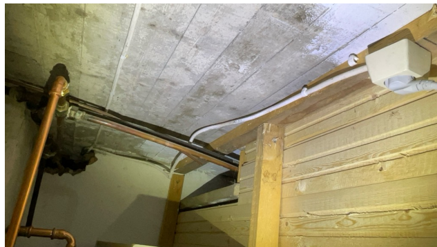
Uklamret kabel kjeller
