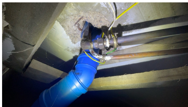
Eldre rør m/irr
