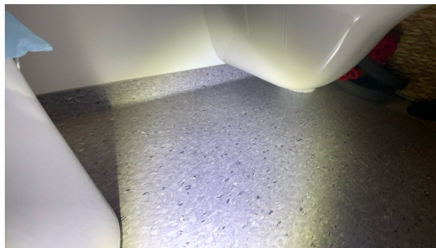
Ikke synlig dreneringsløsning toalett
