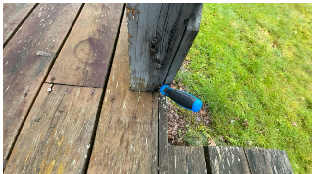
Eksempel røte i rekkverkstolpe
