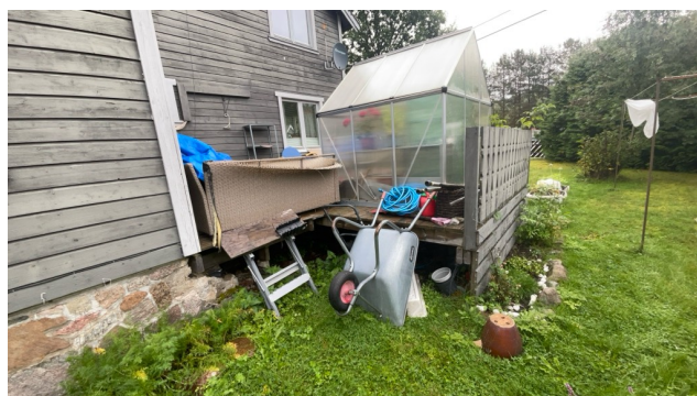
Åpning uten rekkverk
