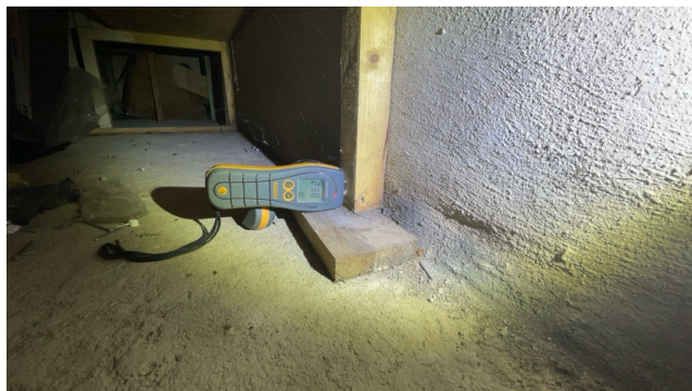
Treverk mot vegg med 23 vekt% fukttinnhold kjeller
