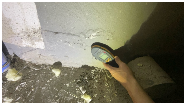
Synlig saltutslag og forhøyede fuktsøk i nedkant kjellermur.
