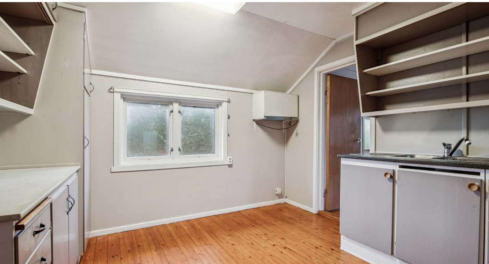
Kjøkken i 2. etasje har eldre innredning.
