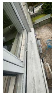
Glippe mellom vannbrett og vinduskarm
