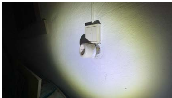
Løs kontakt ved kjøkken kjeller.
