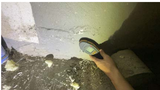
Synlig saltutslag og forhøyede fuktsøk i nedkant kjellermur.
