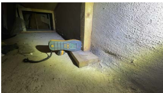
Treverk mot vegg med 23 vekt% fuktinnhold kjeller
