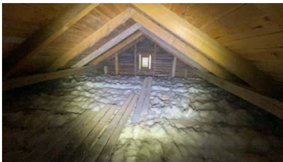
Ventiler i gavl
