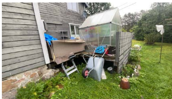
Åpning uten rekkverk
