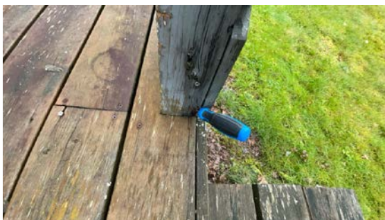
Eksempel råte i rekkverkstolpe
