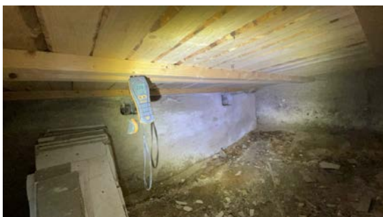
Kryperom med over 23 vekt% i stubbloft av tre. Ikke fuktsperre på mark
