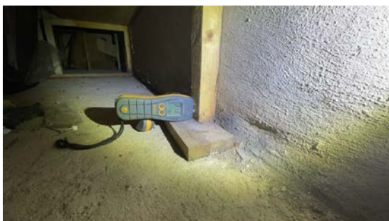
Treverk mot vegg med 23 vekt% fuktinnhold kjeller
