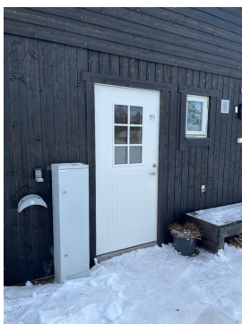
Dør med manglende vannbrett og terskelbeslag.
