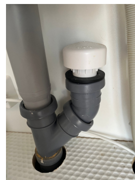
Vakumventil i benkeskap på kjøkken.
