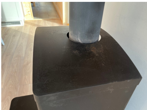
Rustflekker på topp av vedovn.
