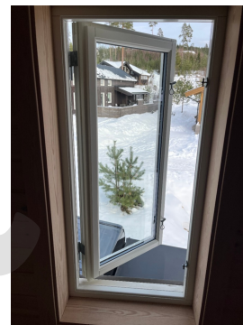
Vinduer i loftetasje mangler barnesikring.
