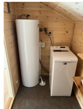
Bod med bl.a. opplegg for vaskemaskin.
