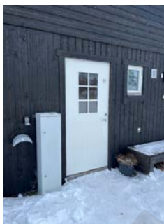
Dør med manglende vannbrett og terskelbeslag.
