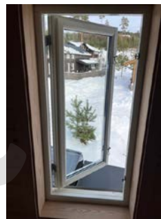
Vinduer i loftetasje mangler barnesikring.
