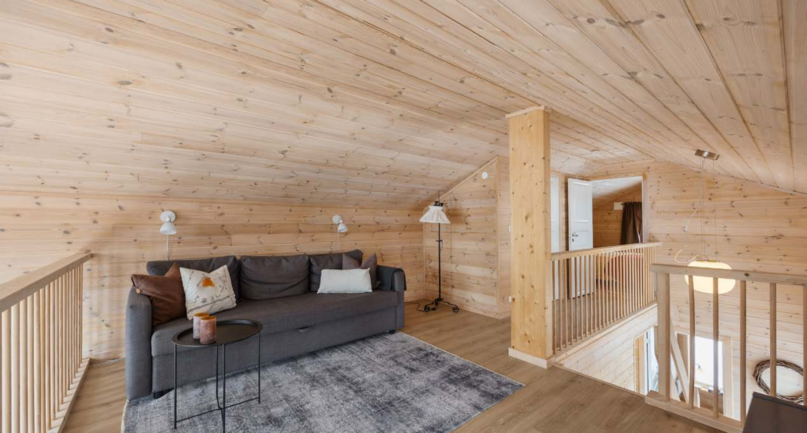
Takhøyden i etasjen er 2,11 m, noe som er lavere enn dagens krav til takhøyde i oppholdsrom for fritidsboliger som er minimum 2,20 m.
