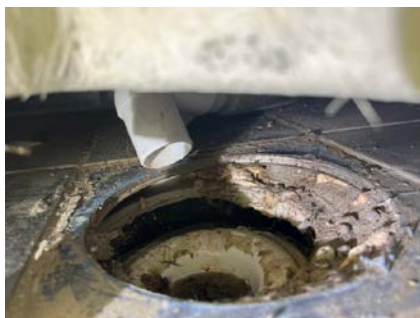
Sluk under kabinett.
