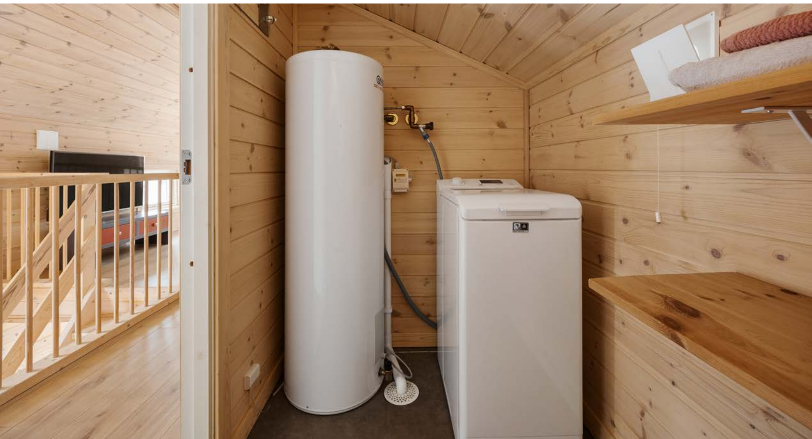
Varmtvannsbereder og vaskemaskin plassert i boden i loftsetasjen.
