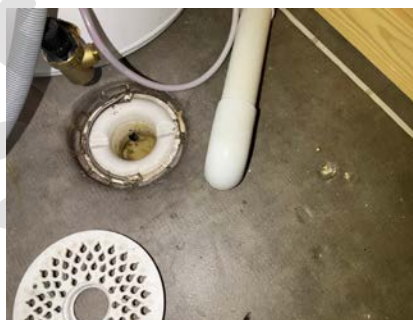
Gulvbelegg og sluk må utbedres.
