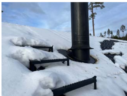
Pipe med beslag.
