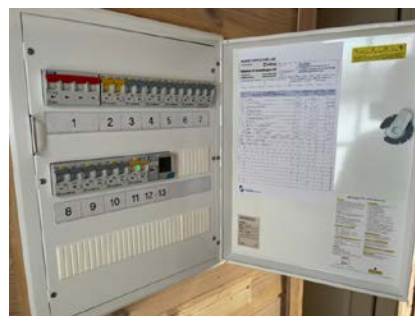
Sikringsskap i entre.
