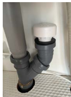
Vakumventil i benkeskap på kjøkken.
