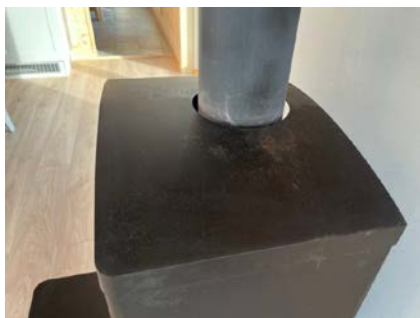
Rustflekker på topp av vedovn.
