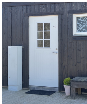
Dør med manglende vannbrett og terskelbeslag.
