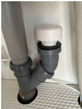
Vakumventil i benkeskap på kjøkken.
