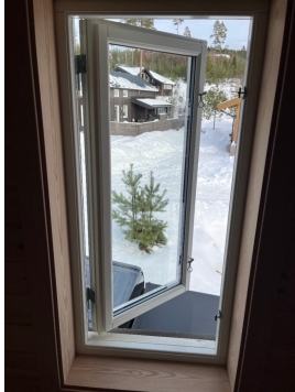
Vinduer i loftetasje mangler barnesikring.
