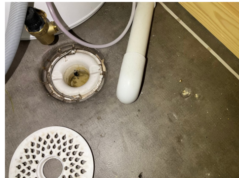
Gulvbelegg og sluk må utbedres.
