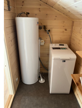
Bod med bl.a. opplegg for vaskemaskin.
