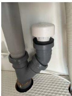
Vakumventil i benkeskap på kjøkken.
