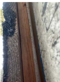
Bilde tatt i underkant av kledning og viser fra venstre, kledning, liggende lekt og vindtettduk.
