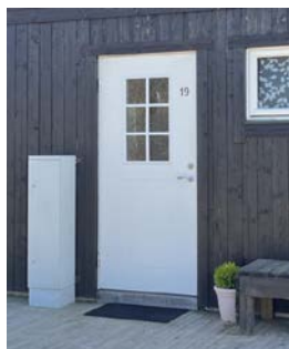
Dør med manglende vannbrett og terskelbeslag.
