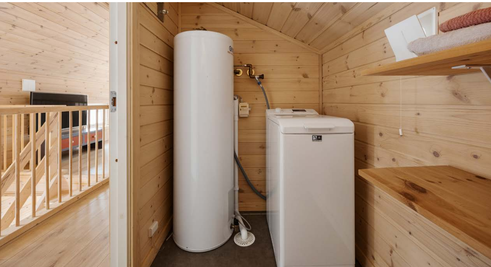
Bildet viser boden i loftsetasjen. Her er varmtvannsbereder og vaskemaskin plassert.
