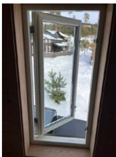
Vinduer i loftetasje mangler barnesikring.
