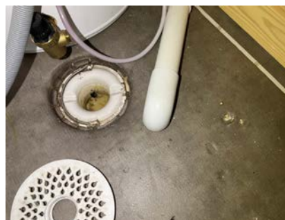
Gulvbelegg og sluk må utbedres.
