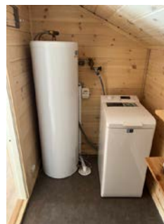
Bod med bl.a. opplegg for vaskemaskin.
