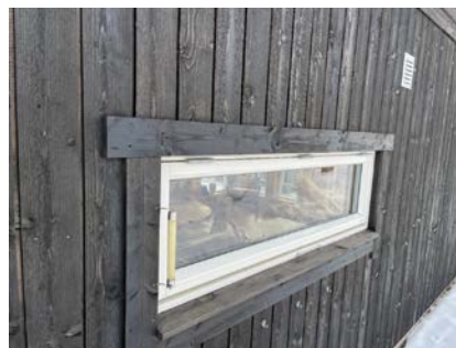
Vindu med manglende vannbrett over vindu og vannbrett under vindu av tre.
