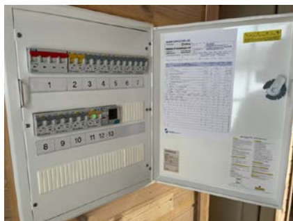
Sikringskapp i entre.
