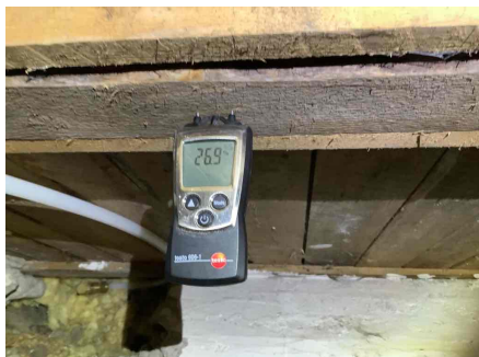
Bildet viser fuktmåling i gulvbjelke.
