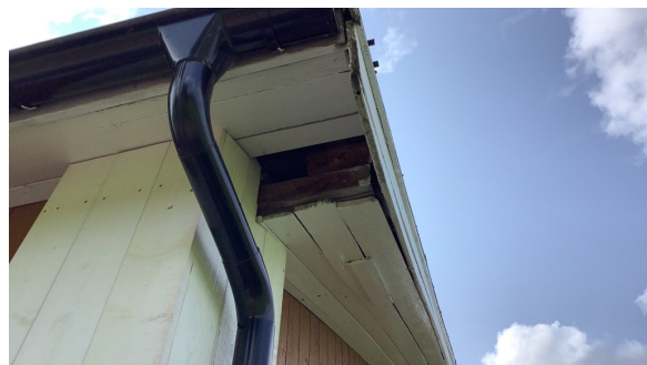
Ende av takutstikk er ikke igjenkledd.
