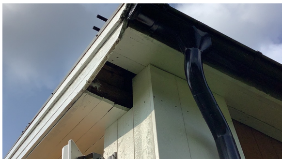
Ende av takutstikk er ikke igjenkledd.
