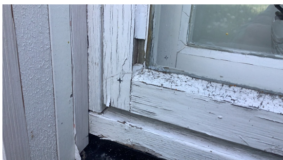
Eksempel på værslitt vindu.
