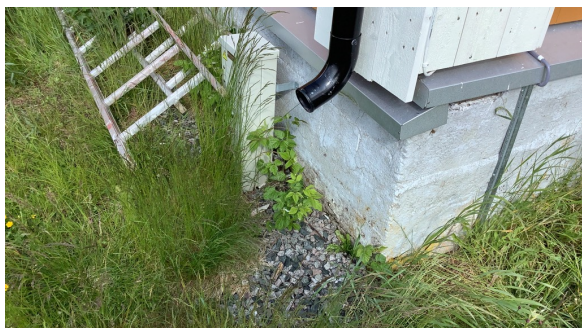
Mangelfull bortledning av takvann.
