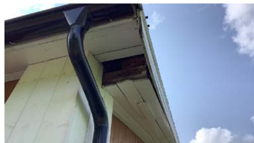
Ende av takutstikk er ikke igjenkledd.
