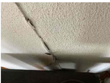
Bildet viser løs puss på brannfast plate.
