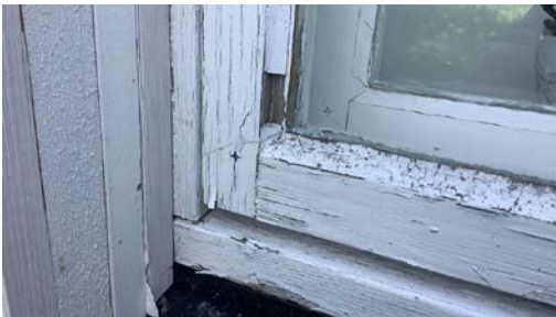
Eksempel på værslitt vindu.
