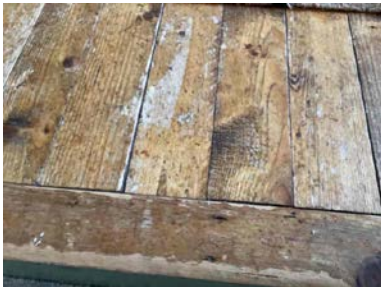
Bildet viser et eksempel på slitasje på gulv.
