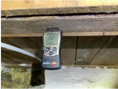
Bildet viser fuktmåling i gulvbjelke.
