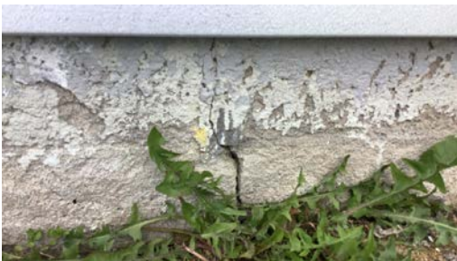
Bildet viser et eksempel på utvendig sprekk i ringmuren.
