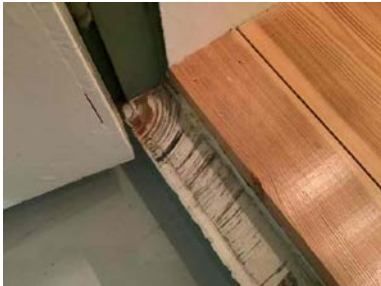
Bildet viser slitasje på dørterskel, og dette er et tegn på justeringsbehov.
