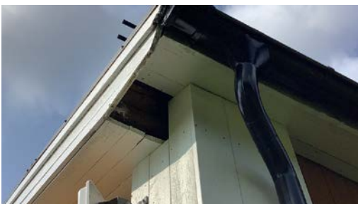
Ende av takutstikk er ikke igjenkledd.
