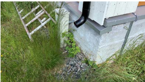
Mangelfull bortledning av takvann.
