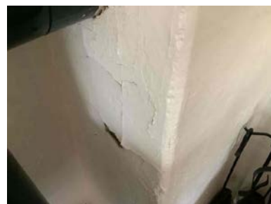
Bildet viser riss i puss.
