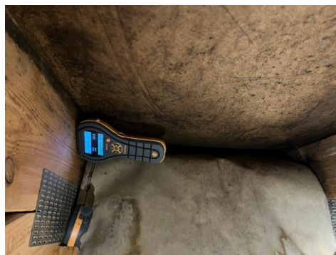
Fuktmåling på kneloft viste ca. 13 %, som er normalt.
