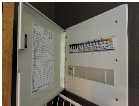
El-skap i soverom 1.etasje.
