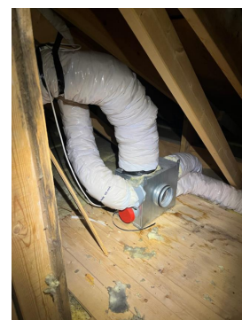
Avtrekksmotor for hoveddel på kneloft.
