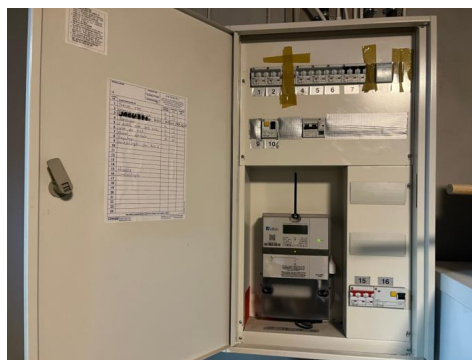
El-skap med måler i teknisk rom underetasje.
