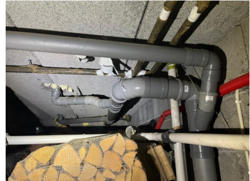
Åpent røranlegg i bod underetasje.
