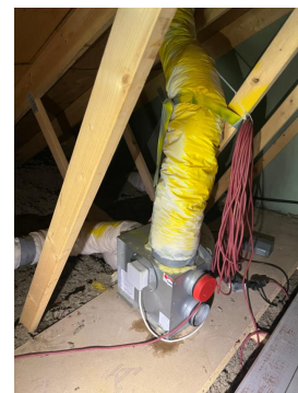
Avtrekksmotor for leilighet på møneloft over leilighet.
