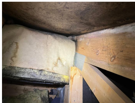
Synlig tegn på kondens på kneloft. Bilde er av isolert skråtak.
