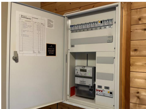
El-skap med måler i vaskerom leilighet.
