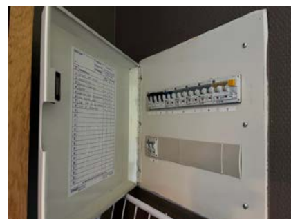
El-skap i soverom 1.etasje.
