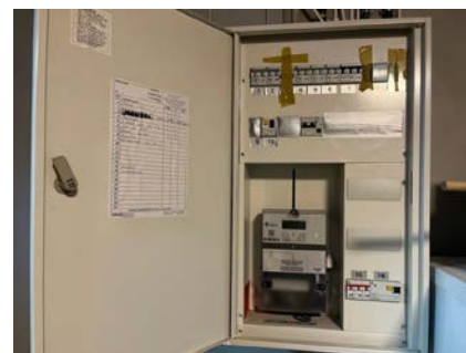
El-skap med måler i teknisk rom underetasje.
