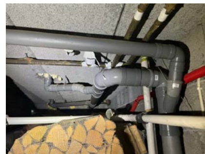
Åpent røranlegg i bod underetasje.
