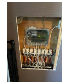
Fordelerstokk i soverom 1.etasje.
