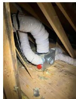
Avtrekksmotor for hoveddel på kneloft.
