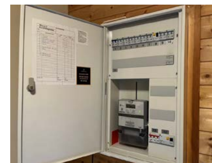
El-skap med måler i vaskerom leilighet.
