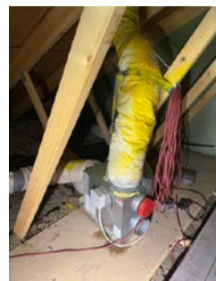
Avtrekksmotor for leilighet på møneloft over leilighet.
