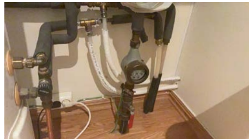
Vanninntak på bodrom.
