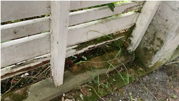
Råte i rekkverk under veranda.
