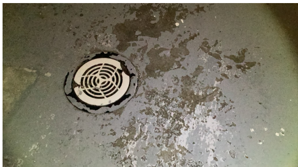
Avskaling av maling på gulv.
