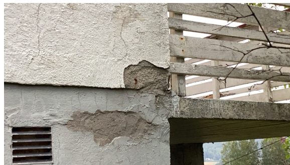
Eksempel på avskaling på mur.
