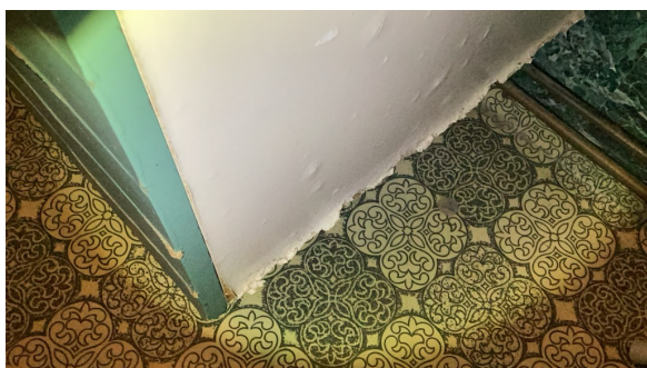
Slitasje på overflater på innredning.
