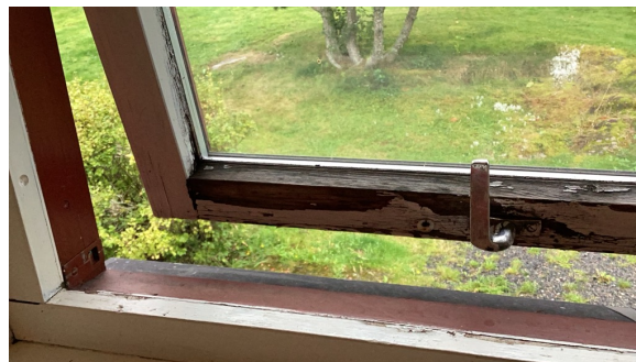
Eksempel på slitasje.
