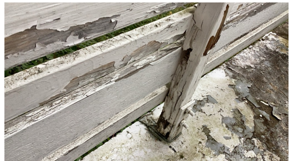
Råte i rekkverk på veranda.
