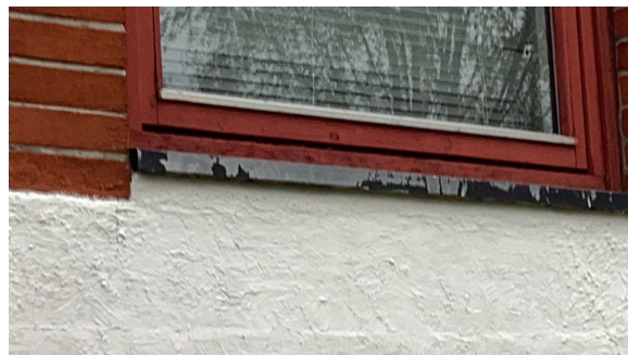
Avskaling på vindusbeslag.
