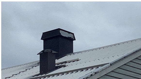
Avskaling på pipebeslag
