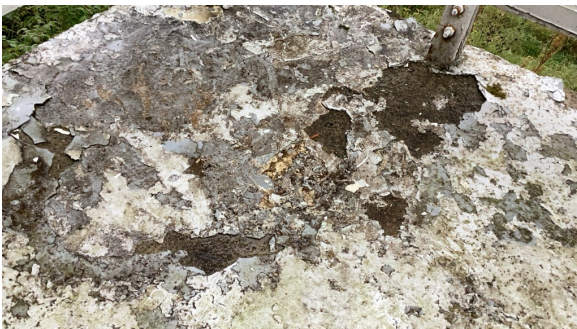
Slitasje på gulv på veranda.
