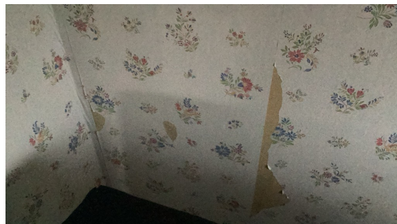
Eksempel på slitasje.
