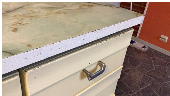
Eksempel på slitasje.
