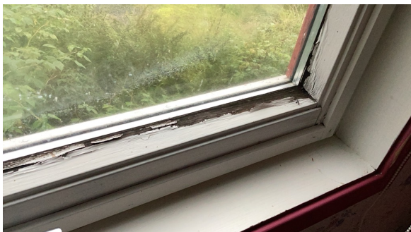
Eksempel på slitasje.
