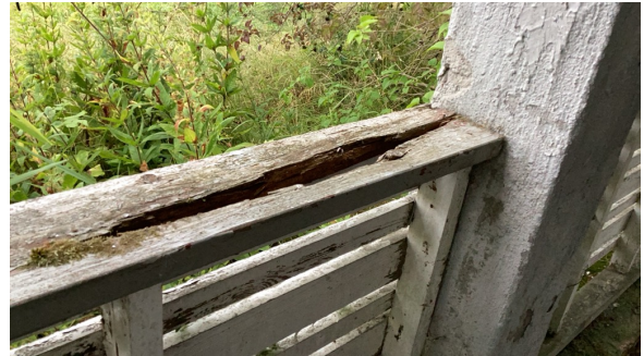
Råte i rekkverk under veranda.
