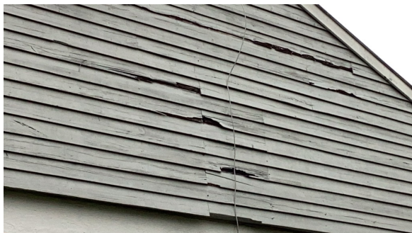
Stedvis råteskader på trefasade.
