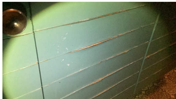
Slitasje på overflater på innredning.
