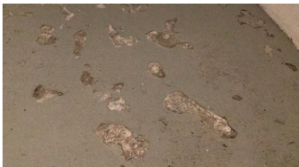
Avskaling av maling på gulv.
