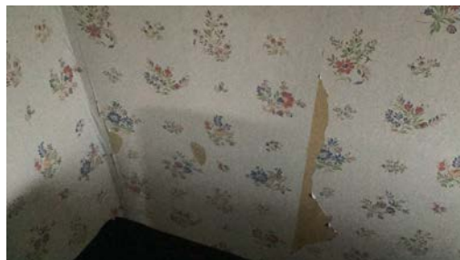
Eksempel på slitasje.
