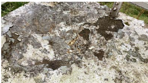
Slitasje på gulv på veranda.
