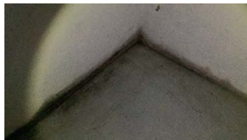
Tegn til fuktpåkjenning på grunnmur.
