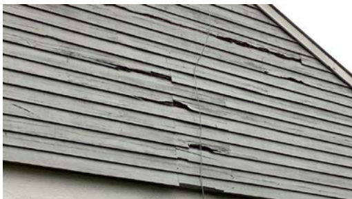
Stedvis råteskader på trefasade.
