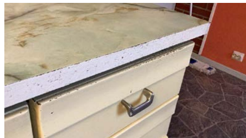
Eksempel på slitasje.
