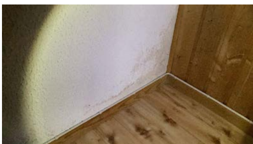
Tegn til fuktpåkjenning på grunnmur.
