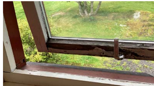
Eksempel på slitasje.
