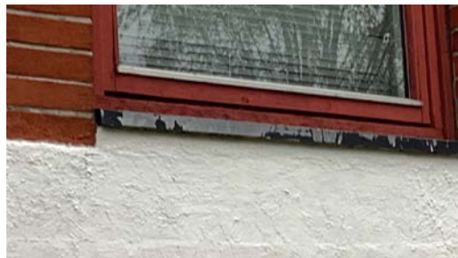
Avskaling på vindusbeslag.
