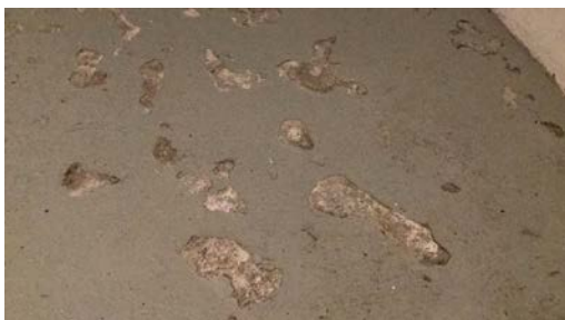
Avskaling av maling på gulv.
