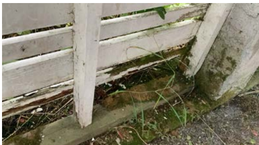
Råte i rekkverk under veranda.
