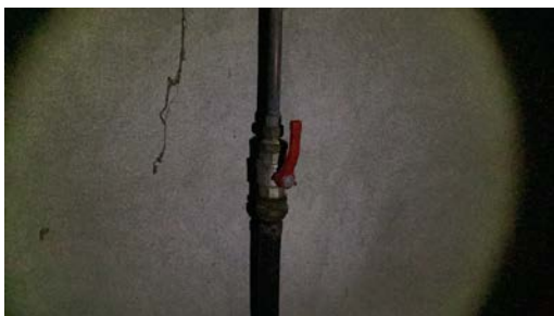
Stoppekran i kjeller.
