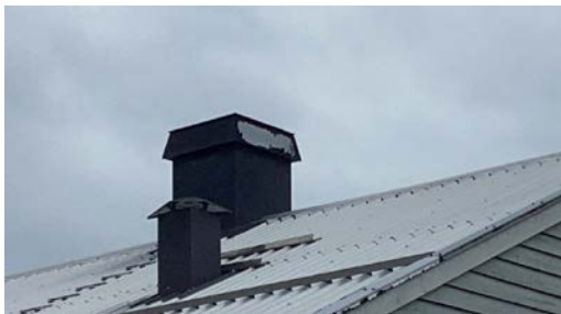
Avskaling på pipebeslag
