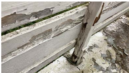
Råte i rekkverk på veranda.
