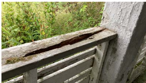
Råte i rekkverk under veranda.
