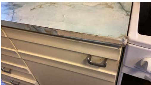
Eksempel på slitasje.
