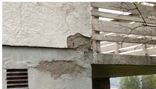
Eksempel på avskaling på mur.
