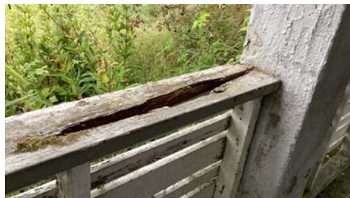
Råte i rekkverk under veranda.
