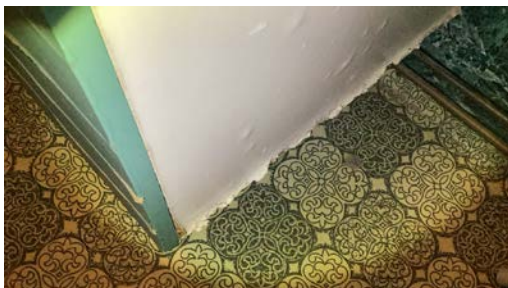
Slitasje på overflater på innredning.
