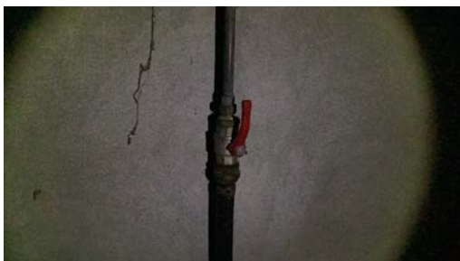
Stoppekran i kjeller.
