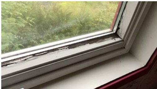
Eksempel på slitasje.
