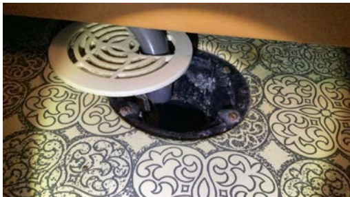
Sluk av plast med klemring.
