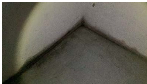
Tegn til fuktpåkjenning på grunnmur.
