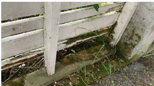
Råte i rekkverk under veranda.
