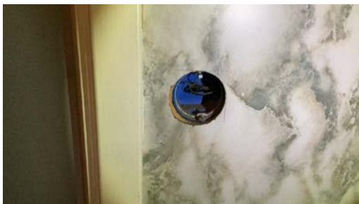
Åpen koblingsboks på vegg-
