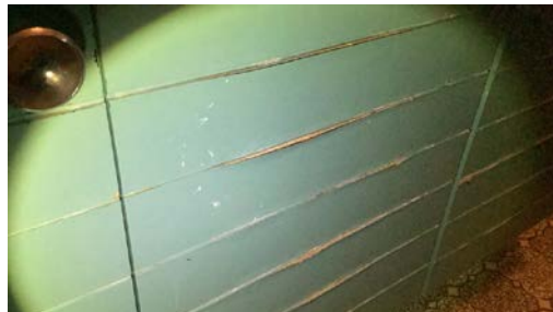
Slitasje på overflater på innredning.
