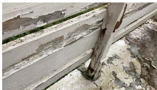
Råte i rekkverk på veranda.
