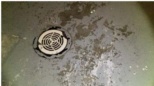
Avskaling av maling på gulv.
