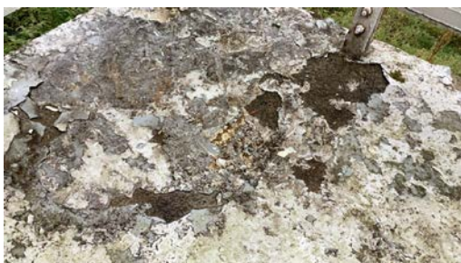
Slitasje på gulv på veranda.
