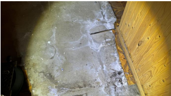
Det er saltutslag på betonggulv.
