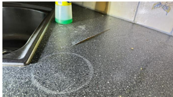
Det er registrert fuktsvell i benkeplate.
