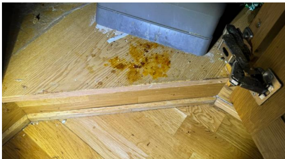
Det er registrert fuktsvell i skrog under servanten.
