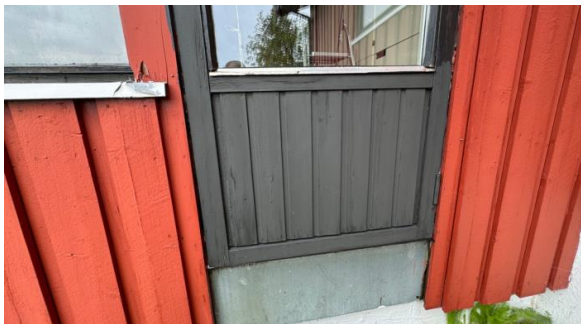
Balkongdør er værslitt.
