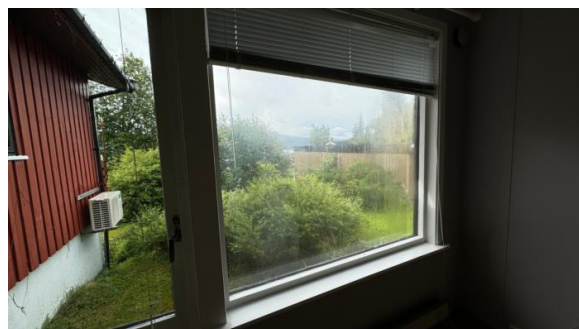
Det er registrert vinduer med punktert glass.
