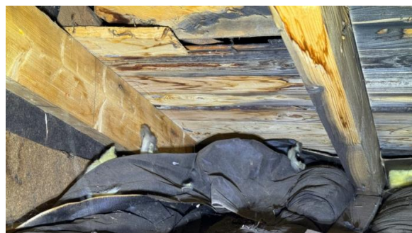
Det er registrert noe fuktmerker i taktro.
