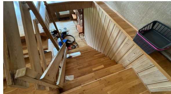
Det mangler håndløper på vegg i trappeløpet.
