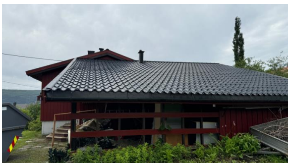
Det er ikke montert snøfangere.
