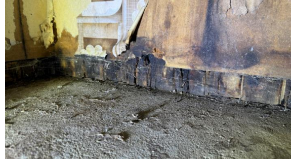
Det er registrert råteskader i innforede vegger.
