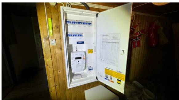
Kontroll av el-skap og kursfortegnelse.
