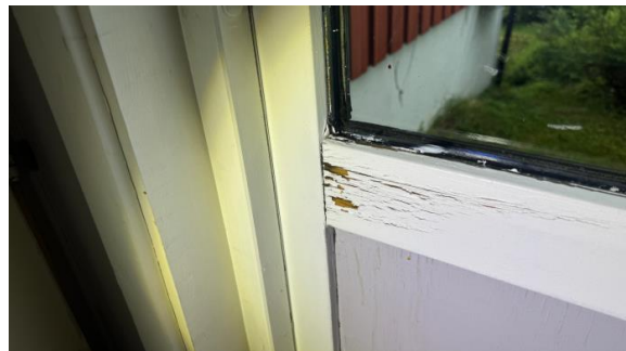
Det er tegn til innvendig kondensering på balkongdør på soverom.
