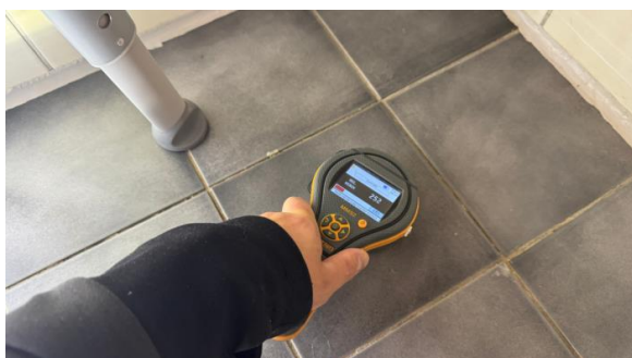
Forhøyede fuktverdier er registrert i våtsone.
