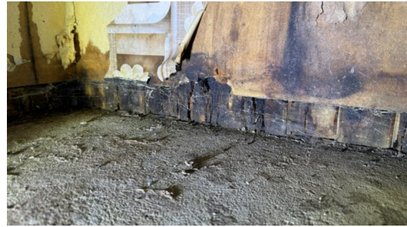
Det er registrert råteskader i våtsone.
