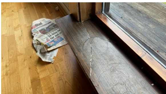
Det er registrert skader på vindusbrett.
