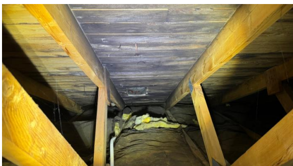
Det er registrert noe soppvekst i taktro. Soppvekst skyldes som regel dårlig lufting eller at det lekker varm fuktig luft fra boligrom og opp på kaldloftet.
