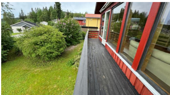
Rekkverket har skjevheter.
