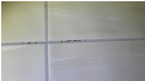
Det er registrert risser/sprekki i flisfuger i våtsone.
