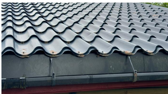
Taktekke har noe rust.
