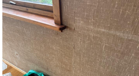
Det er registrert noe slitasje på enkelte overflater.
