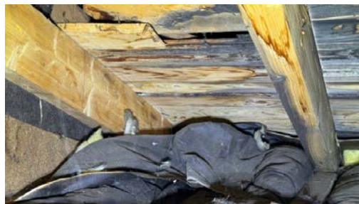
Det er registrert noe fuktmerker i taktro.
