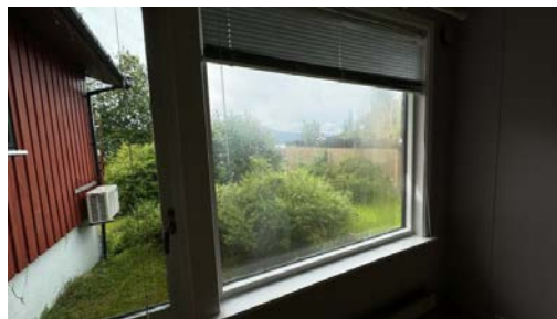
Det er registrert vinduer med punktert glass.
