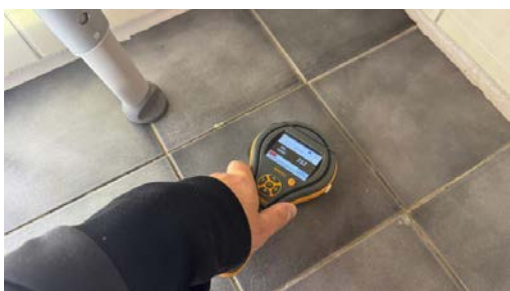
Forhøyede fuktverdier er registrert i våtsone.
