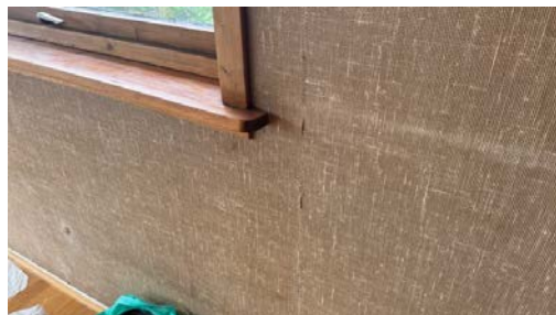
Det er registrert noe slitasje på enkelte overflater.
