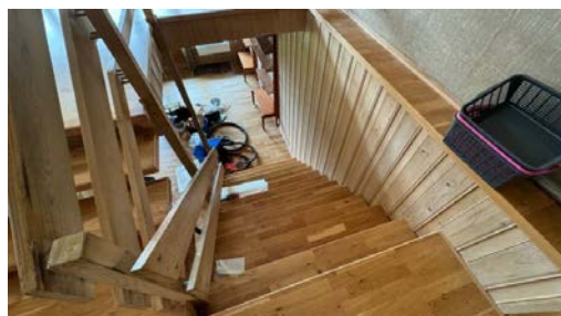
Det mangler håndløper på vegg i trappeløpet.
