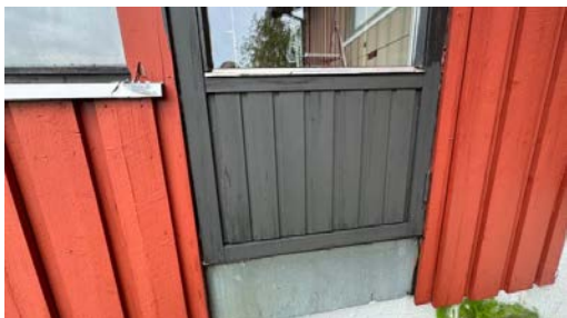
Balkongdør er værslitt.
