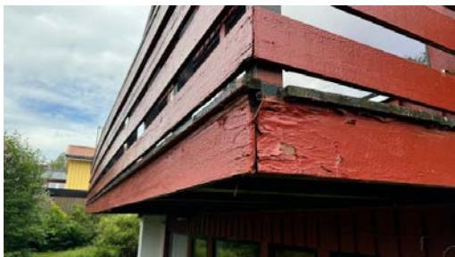
Det er noe råteskader i pyntebord på balkongen.
