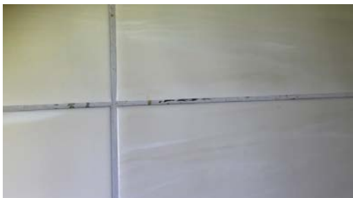
Det er registrert risser/sprekk i flisfuger i våtsone.
