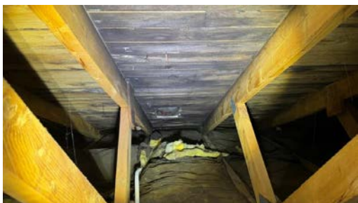
Det er registrert noe soppvekst i taktro. Soppvekst skyldes som regel dårlig lufting eller at det lekker varm fuktig luft fra boligrom og opp på kaldloftet.
