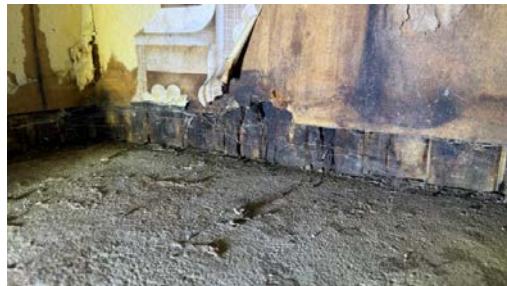
Det er registrert råteskader i innforede vegger.
