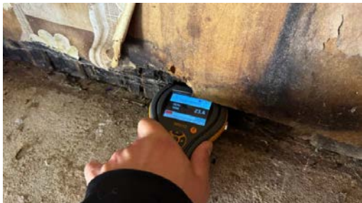
Det er målt forhøyede fuktverdier i innforede vegger.
