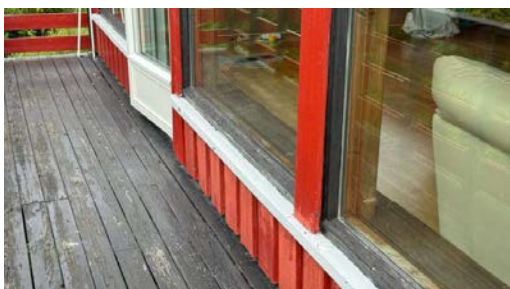
Vinduer er utvendig værslitt.
