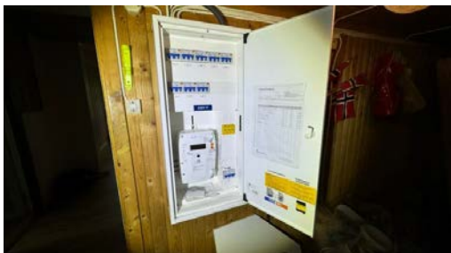
Kontroll av el-skap og kursfortegnelse.
