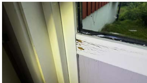
Det er tegn til innvendig kondensering på balkongdør på soverom.
