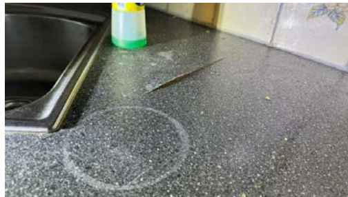
Det er registrert fuktsvell i benkeplate.
