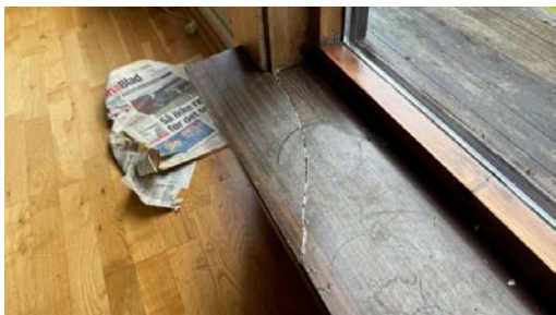
Det er registrert skader på vindusbrett.
