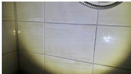
Det er registrert risser/sprekk i flisfuger i våtsone.
