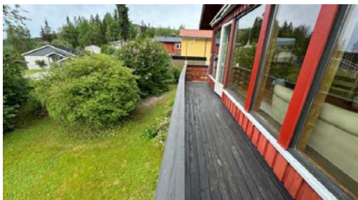
Rekkverket har skjevheter.
