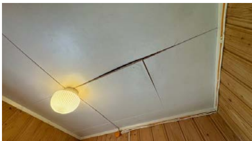
Det er registrert fuktsvell i taket i gangen.
