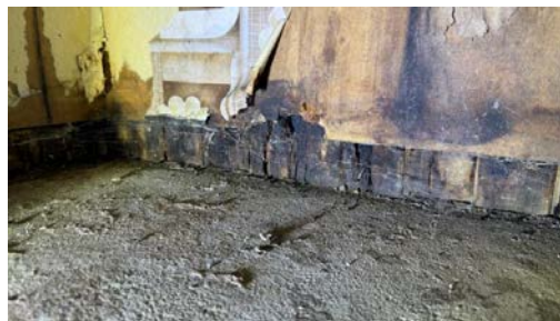
Det er registrert råteskader i våtsone.
