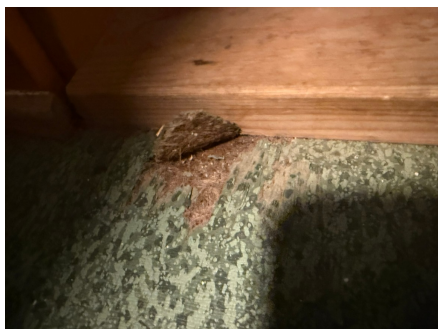
Eksempel skade i belegg.
