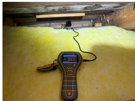
Fuktmåling i trobord.
