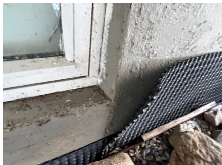
Overgang mellom fuktsikring og murpuss mangler overdekning/liste.
