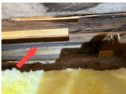
Eksempel på kondensering på undertak.
