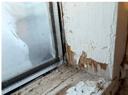
Eksempel på fuktskadet vindu.
