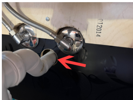
Rørgjennomføring under vask er ikke tett,
