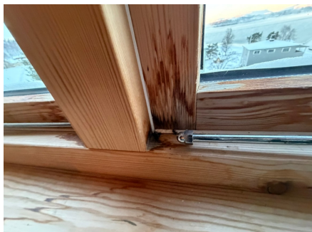
Eksempel fuktmerke på vindu.
