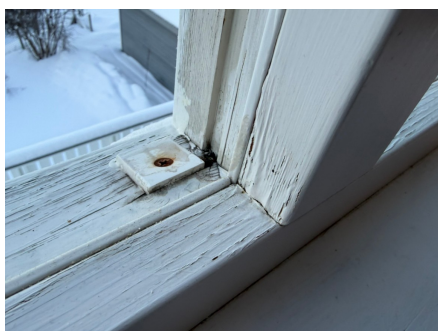
Eksempel fuktmerker i karm.
