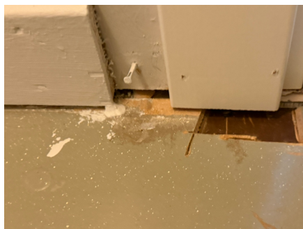
Eksempel på manglende lister.
