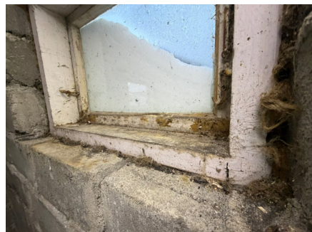
Eksempel på fuktskadet vindu.
