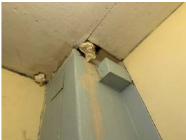
Eksempel på slitte overflater
