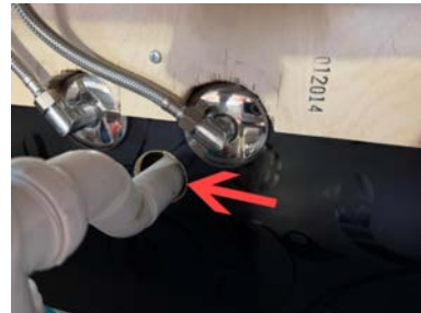
Rørgjennomføring under vask er ikke tett,
