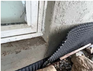
Overgang mellom fuktsikring og murpuss mangler overdekning/list.
