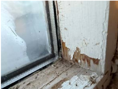
Eksempel på fuktskadet vindu.
