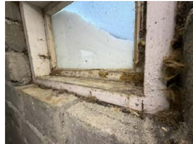
Eksempel på fuktskadet vindu.
