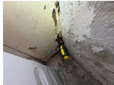
Eksempel på råteskadet treverk.
