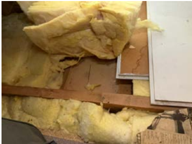
Det er påvist at det ikke er fuktsperre.
