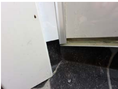
Feil utførelse med bunn og hjørneskinne samt manglende fuge i nedkant av platene.
