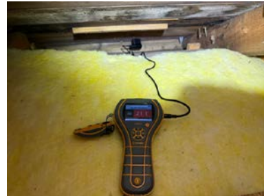
Fuktmåling i trobord.
