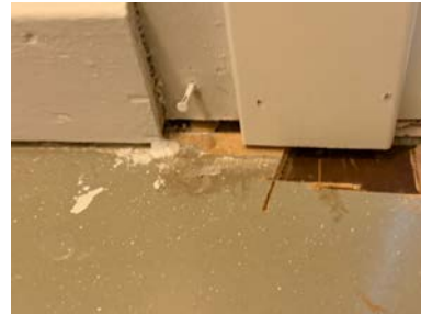
Eksempel på manglende lister.
