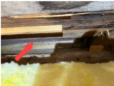
Eksempel på kondensering på undertak.
