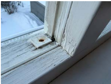
Eksempel fuktmerker i karm.
