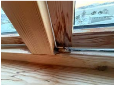
Eksempel fuktmerke på vindu.
