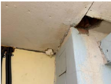
Eksempel på skader i taket.
