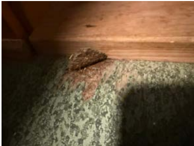
Eksempel skade i belegg.
