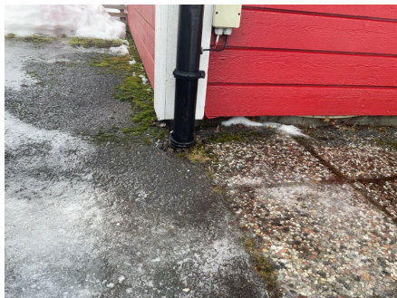
Lav høyde mellom grunnen og kledning, risiko for skader. Anbefalt høyde mellom terreng og kledning er 30 cm.
