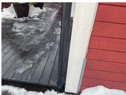
Frostspreng på takrennenedløp.
