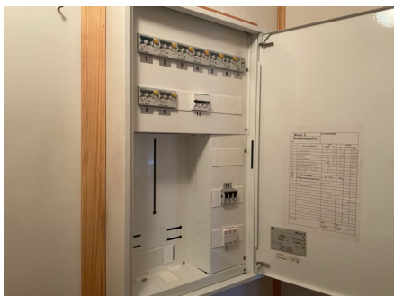
Sikringsskap plassert på bod.
