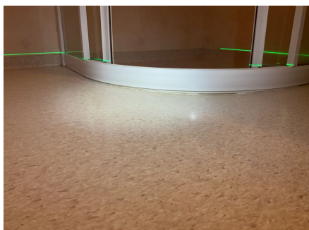
Det er ikke spalte i terskel mot sluk, slik at evt. lekkasjevann vil renne ut av våtrommet i stedet for ned i sluk.
