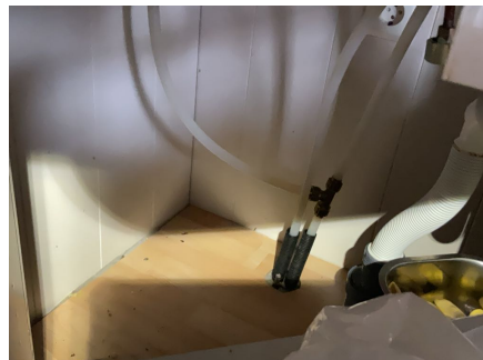
I kjøkkenskap er det ikke tett tilslutning mellom varerør og innerrør for rør i rør system.
