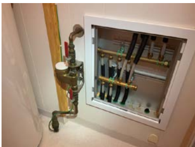
Stoppekran og fordelersskap for vann plassert på bod.
