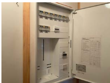
Sikringsskap plassert på bod.
