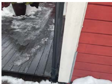
Frostspeng på takrennenedløp.
