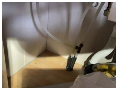
I kjøkkenskap er det ikke tett tilslutning mellom varerør og innerrør for rør i rør system.
