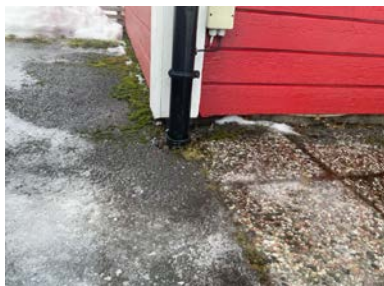
Lav høyde mellom grunnen og kledning, risiko for skader. Anbefalt høyde mellom terreng og kledning er 30 cm.
