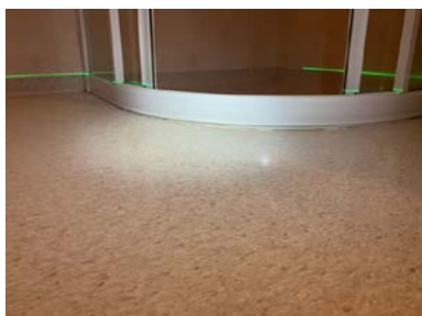
Det er ikke spalte i terskel mot sluk, slik at evt. lekkasjevann vil renne ut av våtrommet i stedet for ned i sluk.
