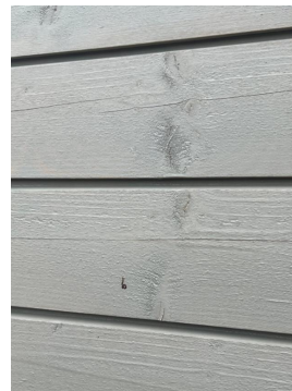
Stedvis sprekker i utvendig kledning
