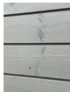
Stedvis sprekker i utvendig kledning
