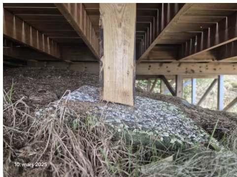
Bildet viser søyle som ikke er forankret på annet vis enn kilt rett mot steinhelle. Det er forøvrig luft mellom søyle og fundament, og bæring oppnås ikke.
