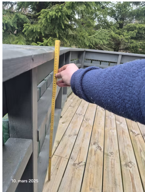
For lavt rekkverk.
