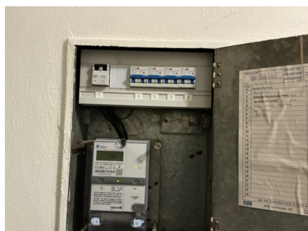
Automatsikringer i sikringsskap plassert i gang/fellesareal.
