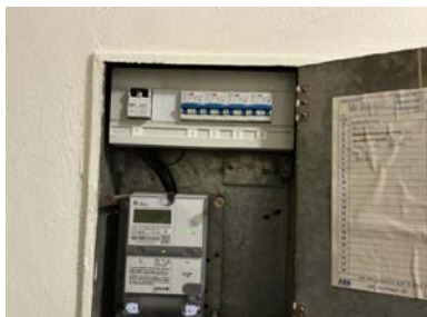
Automatsikringer i sikringsskap plassert i gang/fellesareal.
