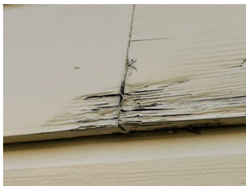
Stedvis synlige råteskader.
