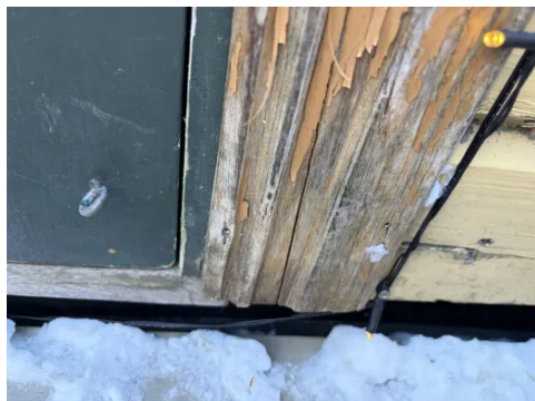
Slitasje på kledning og dekkbord.
