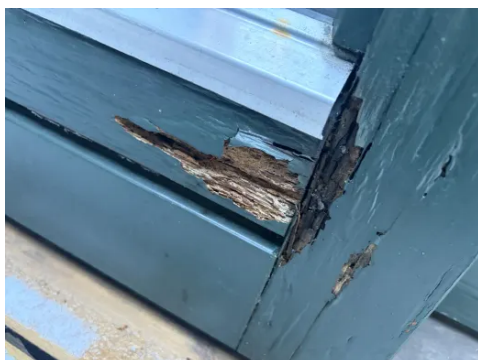
Synlig fuktskade på heve-skyvdør.
