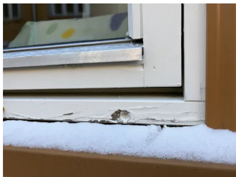
En generell utvendig slitasje på vinduer.
