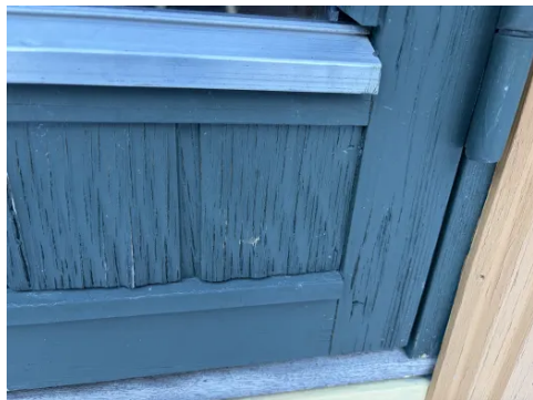
Slitasjer utvendig og utettheter i nedre del på balkongdør.
