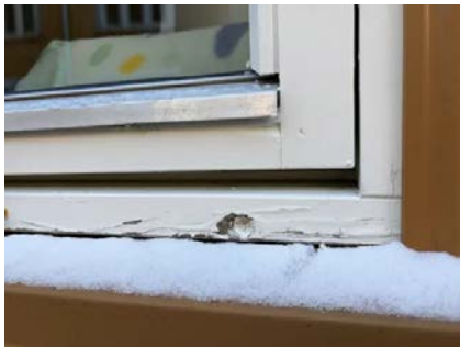
En generell utvendig slitasje på vinduer.
