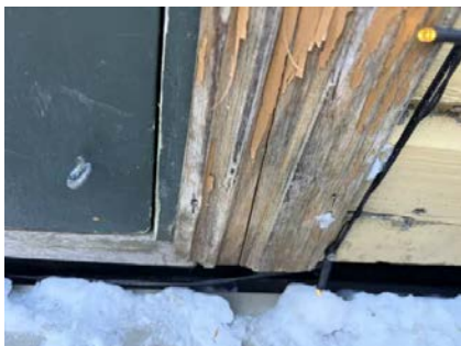
Slitasje på kledning og dekkbord.
