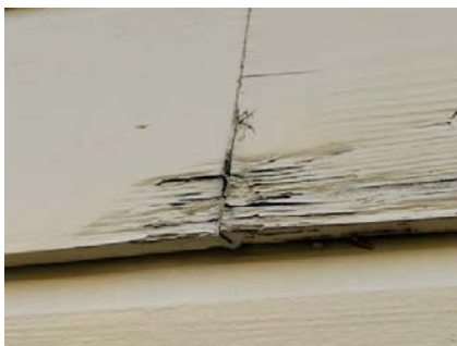
Stedvis synlige råteskader.
