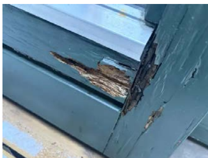
Synlig fuktskade på heve-skyvdør.
