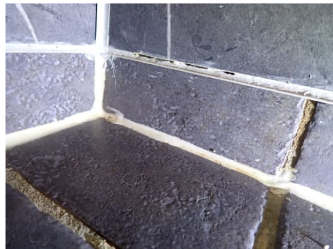
Delvis løsnet silikonfuge i nedre del av plate som kan være årsak til fuktopptrekk og svelling i badersomplaten.
