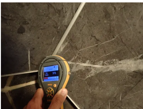
Det registreres fuktopptrekk og svelling i nedre del av baderomsplate.
