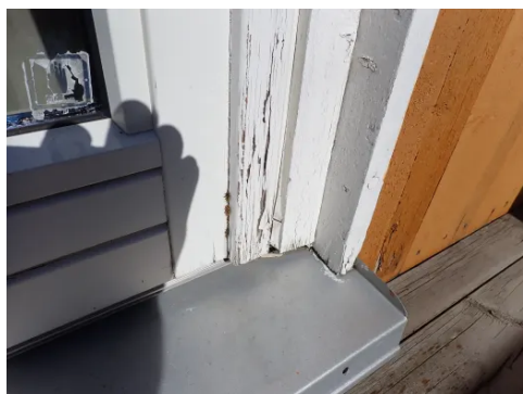
Eksempel på værslitt karm (heveskyvedør).
