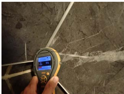
Det registreres fuktopptrekk og svelling i nedre del av baderomsplate.
