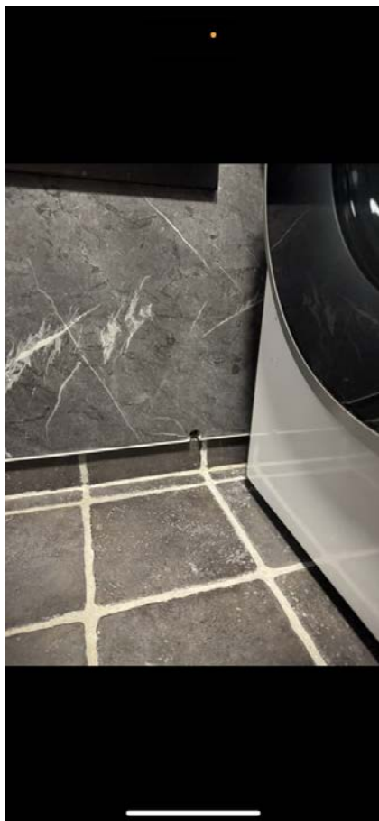
Rør for avrenning fra fordelerskap er etablert for langt inn bak platen med risiko for fukt bak platen ved en eventuell lekkasje.
