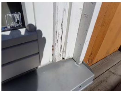
Eksempel på værslitt karm (heveskyvedør).
