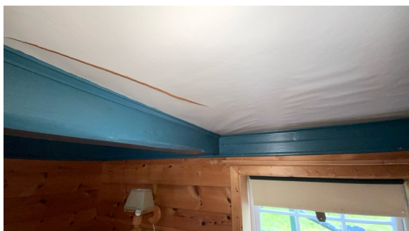
Tapet i himling på stue/kjøkken er løsnet og skadet.
