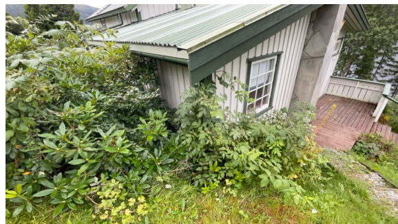
Oversikt. Etter befaringen har selger fjernet deler av plantene for å kontrollere vegg.
