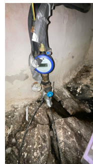
Hovedstoppekrane, vannmåler og reduksjonsventil
