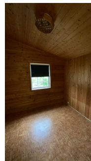
Mangler ventil på soverom i 1. etasje
