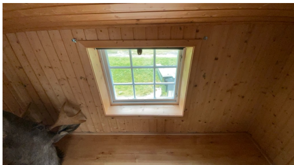
Mangler ventil på allrom loft
