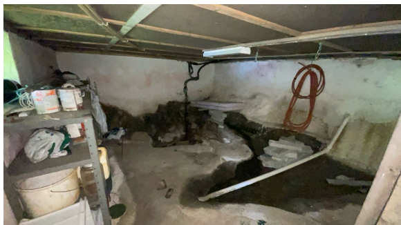
Synlig fukt som kommer via fjellet
