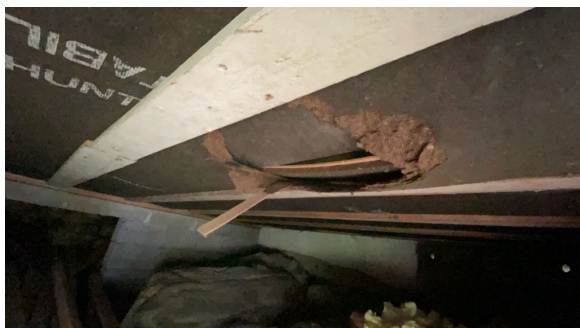
Skade på stubbeloft
