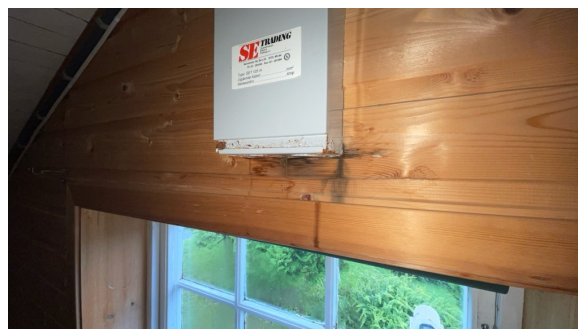
Fuktmerker ved hovedbryter til strøm på loftsgang. Ingen forhøyede fuktverdier er målt på befaringsdagen.
