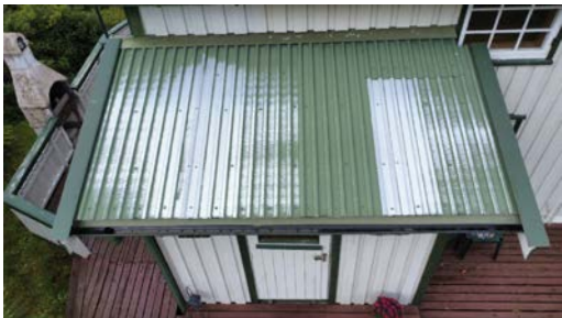
Tak over inngang
