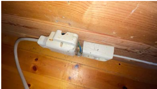
Synlige leder ved kontakt til komfyr
