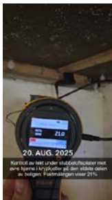
Kontroll av lekt under stubbeloftsplater mot øvre hjørne i krypkjeller på bolig. Fuktmålingen viser 21%
