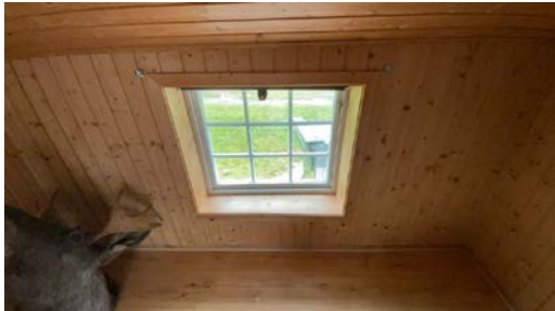
Mangler ventil på allrom loft
