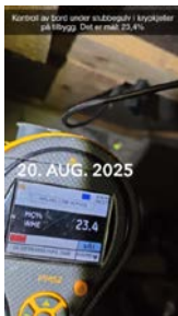
Kontroll av bord på bjelkelag i krypkjeller på tilbygg. Det er målt 23,4%
