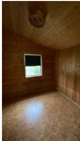
Mangler ventil på soverom i 1. etasje
