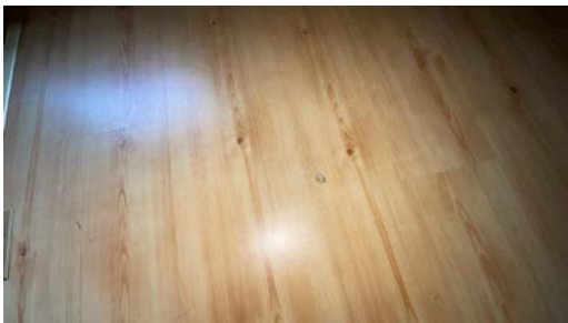
Skade på laminatgulv loftsgang.
