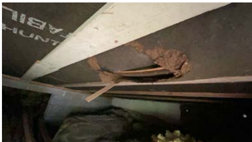
Skade på stubbeloft
