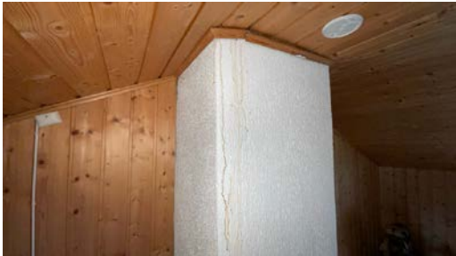
Noe rennemerker på pipeløp
