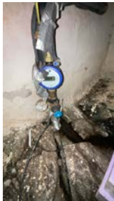
Hovedstoppekrane, vannmåler og reduksjonsventil
