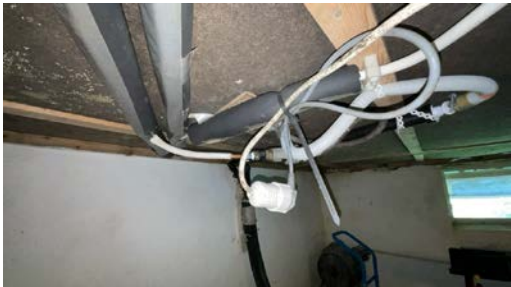
Ikke fagmessig utførelse på tilkobling av oppvaskmaskin
