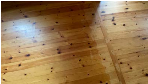
Overflateslitasje/merker i tregulv på stuer/kjøkken
