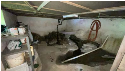
Synlig fukt som kommer via fjellet
