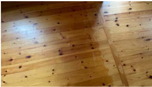
Overflateslitasje/merker i tregulv på stuer/kjøkken
