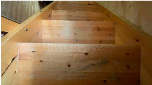
Slitt overflate/merker i trapp
