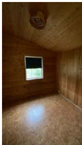
Mangler ventil på soverom i 1. etasje
