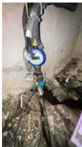
Hovedstoppekrane, vannmåler og reduksjonsventil
