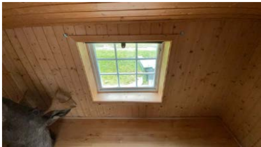
Mangler ventil på allrom loft
