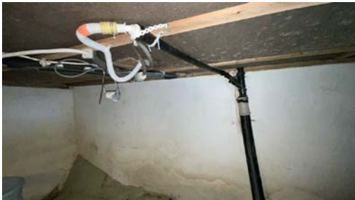
Ikke fagmessig utført arbeid med tilkobling av avløp til oppvaskmaskin
