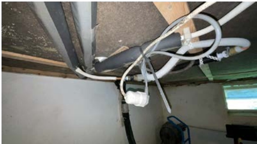
Ikke fagmessig utførelse på tilkobling av oppvaskmaskin
