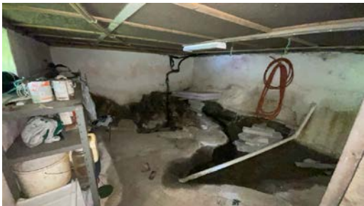
Synlig fukt som kommer via fjellet
