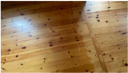
Overflateslitasje/merker i tregulv på stuer/kjøkken
