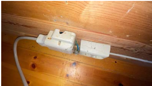
Synlige leder ved kontakt til komfyr
