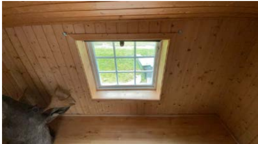
Mangler ventil på allrom loft
