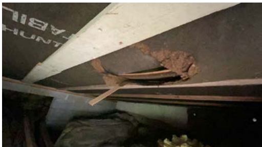
Skade på stubbeloft
