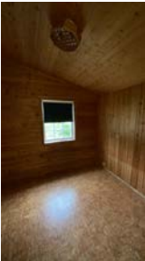
Mangler ventil på soverom i 1. etasje
