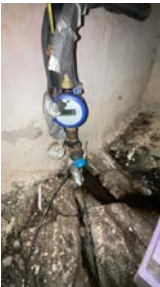
Hovedstoppekrane, vannmåler og reduksjonsventil
