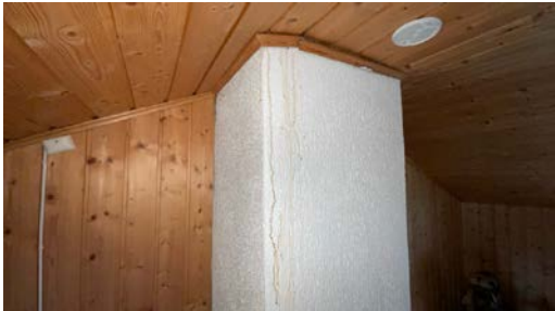
Noe rennemerker på pipeløp
