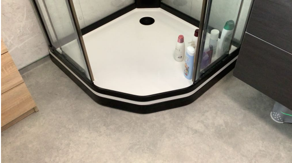
Det er i tillegg sluk under kabinett. Det er ikke vurdert fall i dusjonen.
