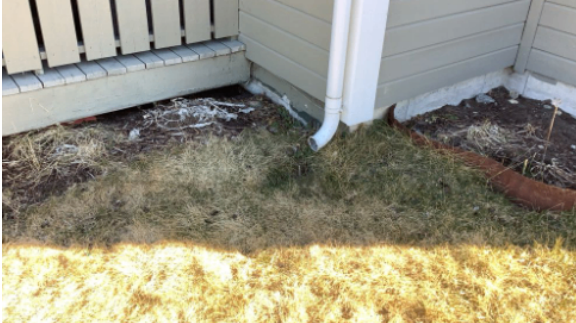
Takvann samler seg mot fundament/såle.
