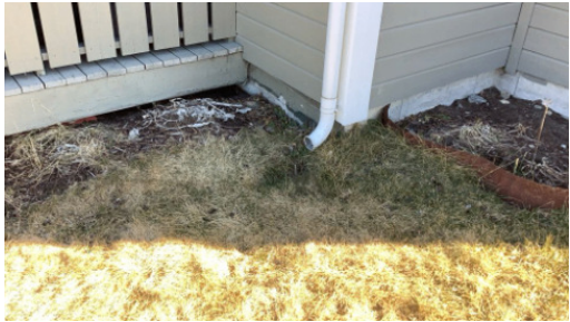
Takvann samler seg mot fundament/såle.
