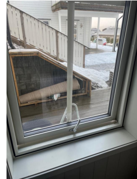
Vindu på soverom må justeres og utbedres.
