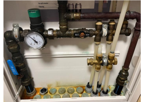
Fordelerskap med kondens.
