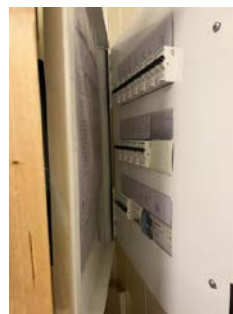
El-skap er begrenset inspisert grunnet tilgang.
