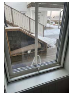
Vindu på soverom må justeres og utbedres.
