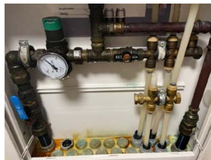
Fordelerskap med kondens.
