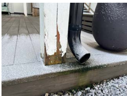
Tresøyler bør utbedres.
