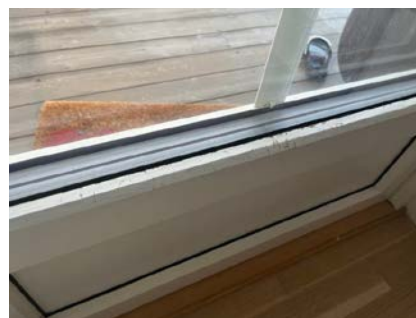
Terrassedør med merker.
