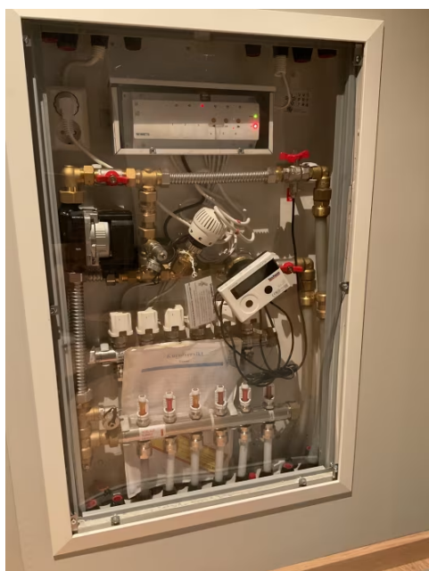
Fordelerskap til vannbåren varme.
