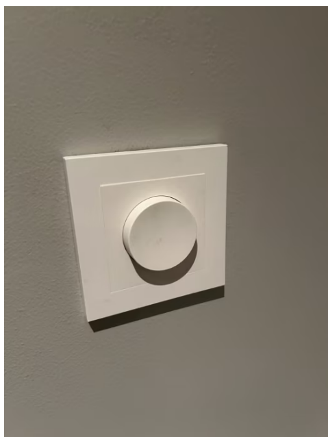
Løs ramme på dimmer i gang
