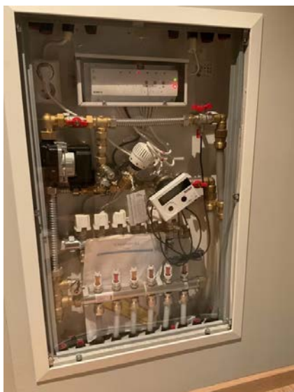
Fordelerskap til vannbåren varme.
