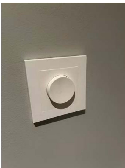
Løs ramme på dimmer i gang
