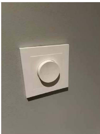
Løs ramme på dimmer i gang
