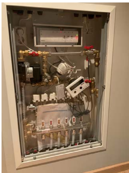
Fordelerskap til vannbåren varme.
