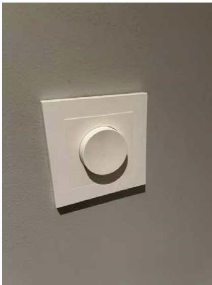
Løs ramme på dimmer i gang
