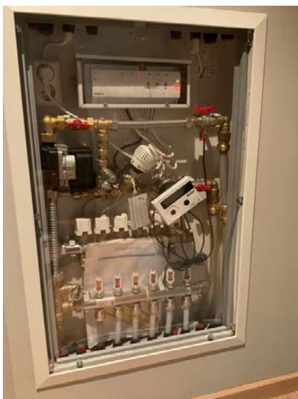
Fordelerskap til vannbåren varme.
