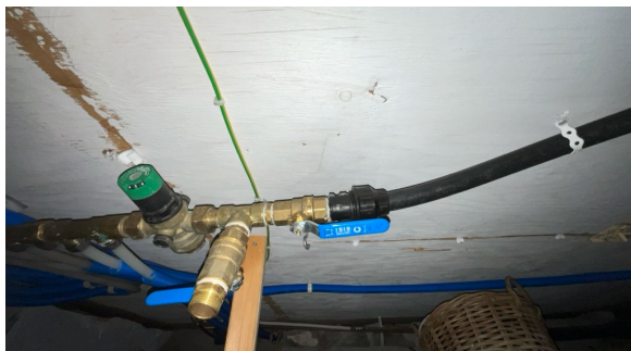
Stoppekran til vann.
