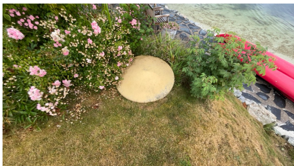
Tank med kværnepumpe.
