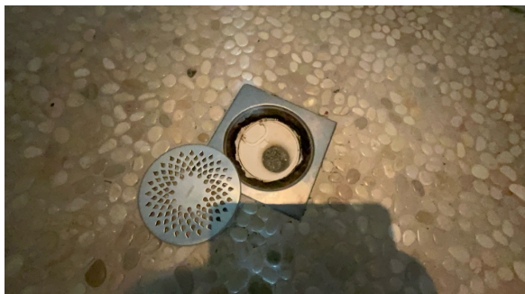
Sluk i gulv.
