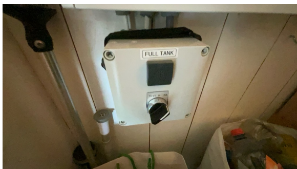
Styreskap til avløpspumpe.
