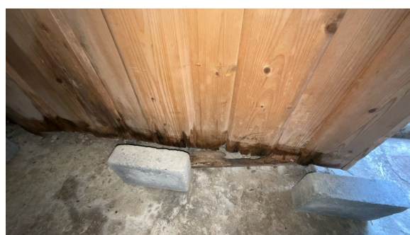
Det er registrert noe råde på panel i kjeller.
