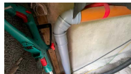
Del av rør til avløp.
