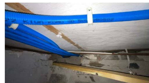
Del av rør til vann.
