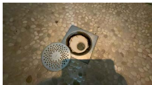
Sluk i gulv.
