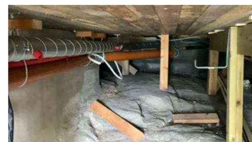
Del av rør til avløp.
