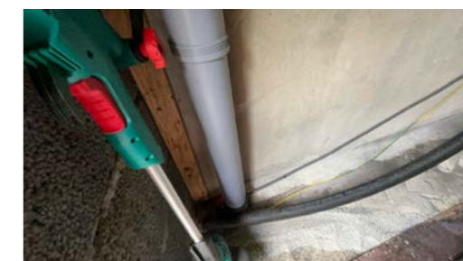
Del av rør til avløp.
