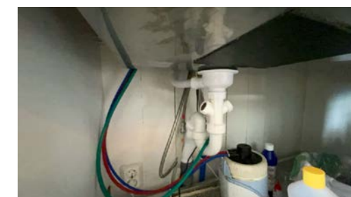
Del av rør til avløp.
