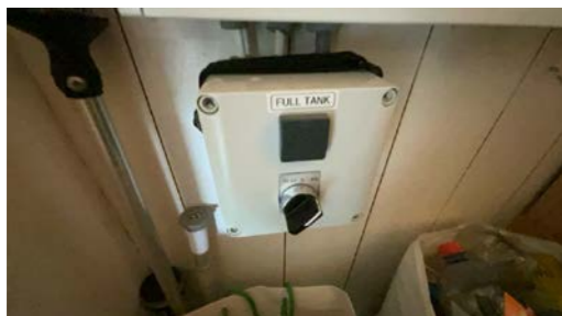
Styreskap til avløpspumpe.
