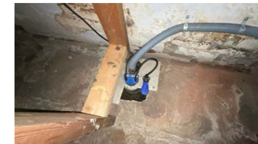
Pumpe montert på gulv i kjeller.
