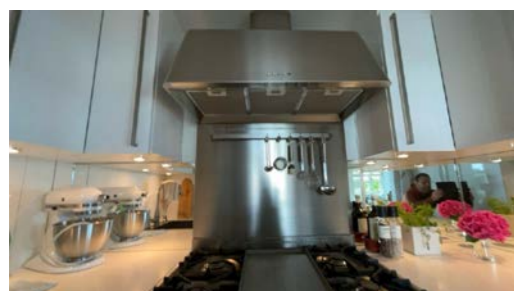
Montert avtrekk over gasskomfyr.
