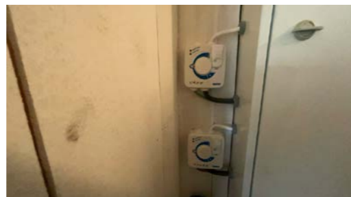
Brytere til varme på vann og avløp.
