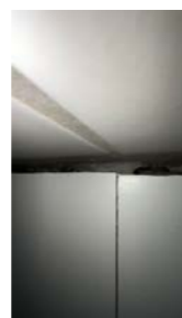
Her ser man at det ikke er etablert oppkant.
