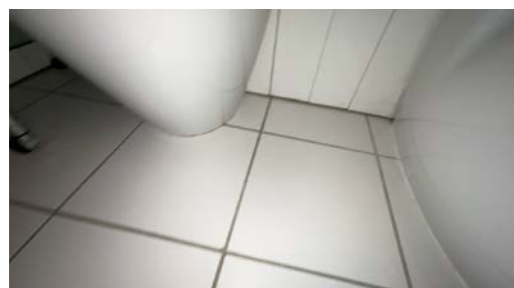
Her ser man at det ikke er etablert oppkant.
