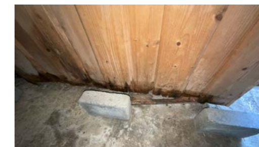
Det er registrert noe råte på panel i kjeller.
