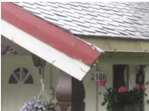
Fuktpåkjønning på nedre del av vindski.
