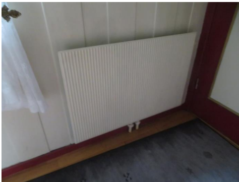
Radiator tilknyttet varmeanlegget.
