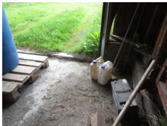
Garasje Sprekk i gulv pga setning.
