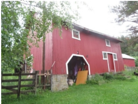
Stabbur Nedre langside av stabburet med adkomst til vognskjul/vedskåle. Merk påviste skjevheter og brudd i mur som følge av svikt i grunn.
