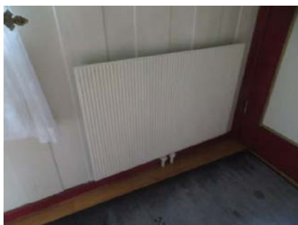
Radiator tilknyttet varmeanlegget.
