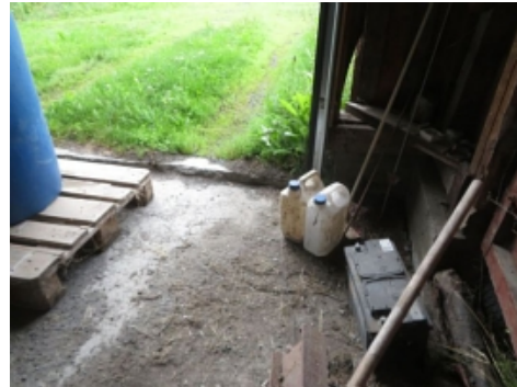
Garasje Sprekk i gulv pga setning.
