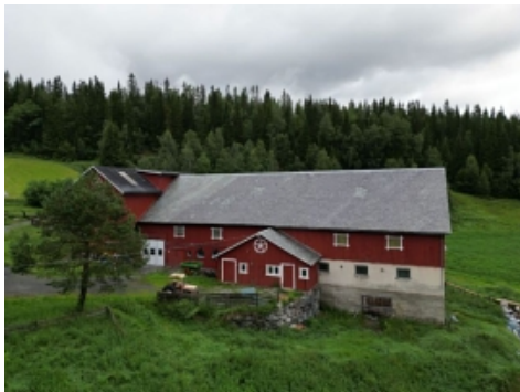
Driftsbygning Skifertekket tak på hoveddel og stålplatetekking på silobygget. Merk avskalling i pussoverflater under vinduer.
