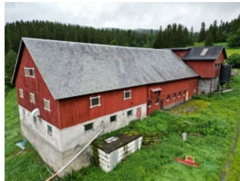
Driftsbygning Pussavskalling under vinduer og manglende omramming etter montering av vinduer. Påvist setningsprekk i veggkonstruksjonen (Skråsprekk over og under ett av vinduene). Merk behov for overflatebehandling av ytre gavlvegg.
