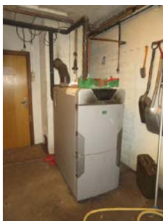
Vedfyrt sentralfyr i kjeller. Installert i 2010.
