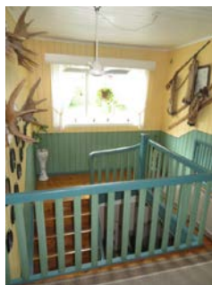
Manglende håndløper på vegg. Rekkverk noe lavt i forhold til dagens krav (Målt til 82 cm).
