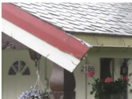
Fuktpåkjennning på nedre del av vindski.
